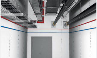
Tubulações e dutos com proteção de selagens resistentes ao fogo.
